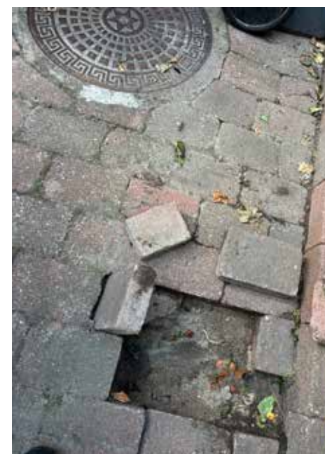
Under de nedsunkne fliser tæt på kloakrøret var et rottehul gemt
