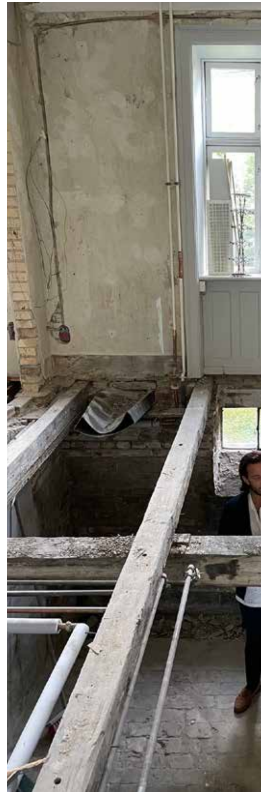
En vaskemaskine havde lækket en bjælke opdagede under udskiftning af gulv. Så
